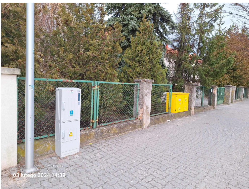
Fot. 2. Lokalizacja skrzynki elektrycznej oraz skrzynek gazowych.
